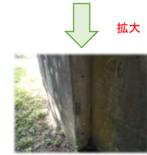
配水池のひび割れ、表面剥離
