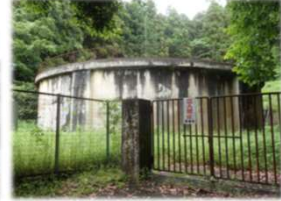
◆ 浦松配水池の老朽化状況
