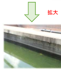
ろ過池のひび割れ
