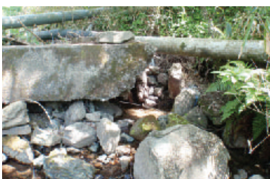
壊れたままの固定井堰
