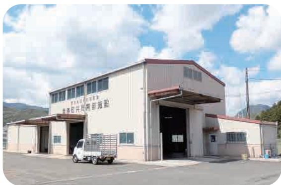
老朽化が進む育苗施設
