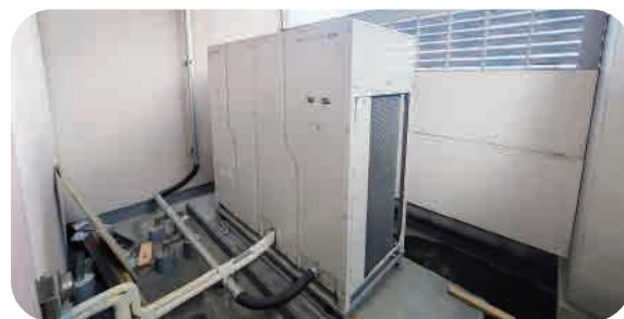
移設する室外機
