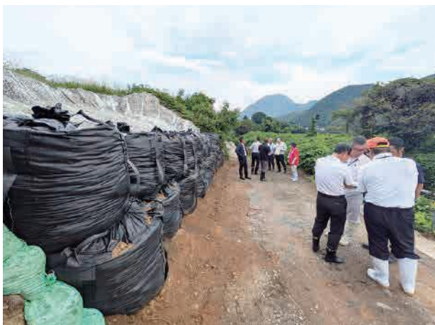
農地法面の崩落現場
